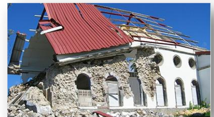
Eglise de Terre de Bas après le séisme de 2004 (BRGM)
